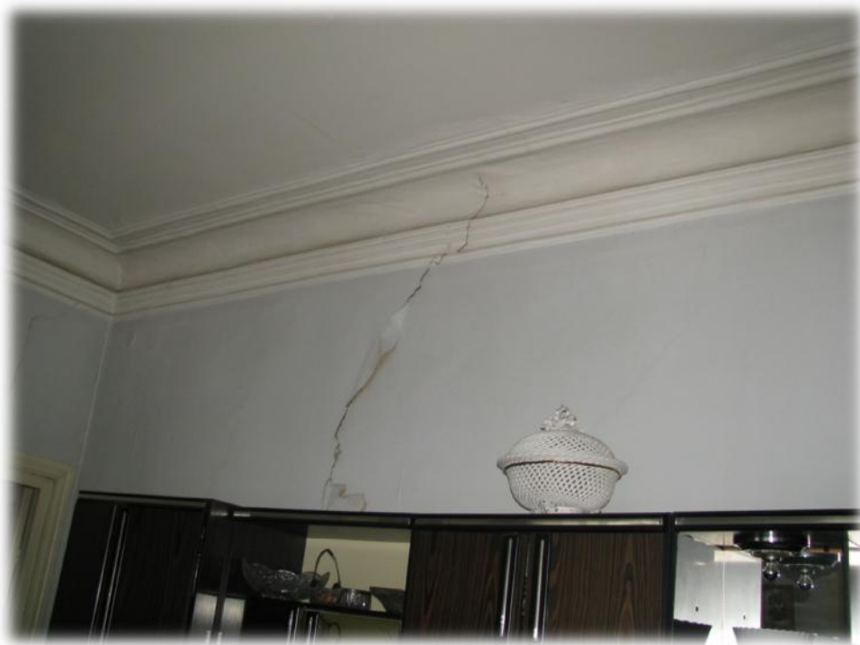
სპრ. №35, ინგერიერი "A" ბლოკი. II - III სართულის დაზიანებული კედლები, ბზარი კედელზე (2-5 მმ).
