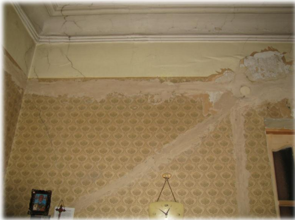
სპრ. №33, ინგერიერი “A” ბლოკი. I სართული, ბზარი კედელზე (3-6 მმ) (“ზ” ღერი “ა-ბ” ღერძებს შორის).
