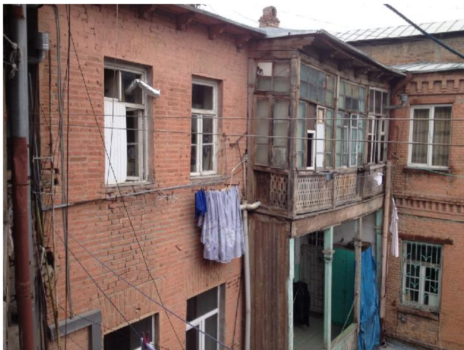
სურ. №61 “C” და “D” ბლოკი. დეფორმირებული და დაზიანებული ხის კონსტრუქციის აივანი და შუშაბანდი.
